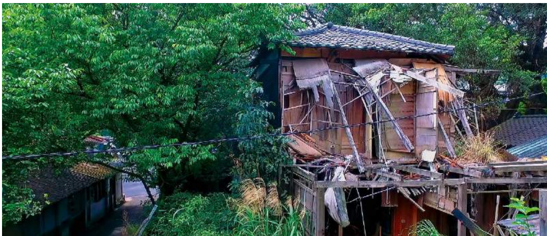
陽明山草山派出所雖被指定歷史建築，政府單位卻無力修復，不僅被堆置大批垃圾，還嚴重破損，有如電影裡的鬼屋場景。
