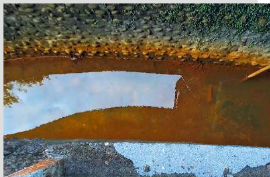
文化資產「中山樓周邊園區文化景觀」裡的歷史建築「青邨圓講堂」，地下一樓積水高達一公尺，孳生蚊蟲，成了名副其實的蚊子館。
